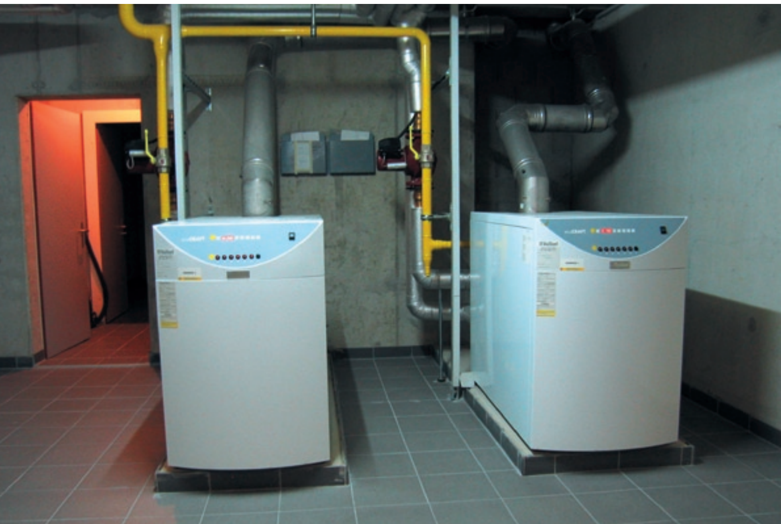
Production de chaleur à gaz pulsé.
