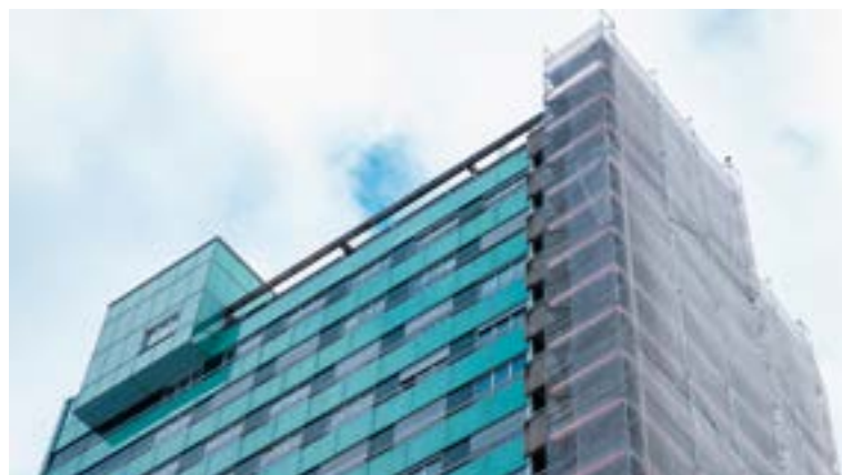
La tour Bournot se transforme pour accueillir des appartements avec encadrement et des logements familiaux.
