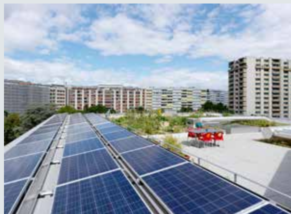
Les panneaux solaires se partagent l'espace du toit avec une terrasse et un potager communs. Annik Wetter/DR
